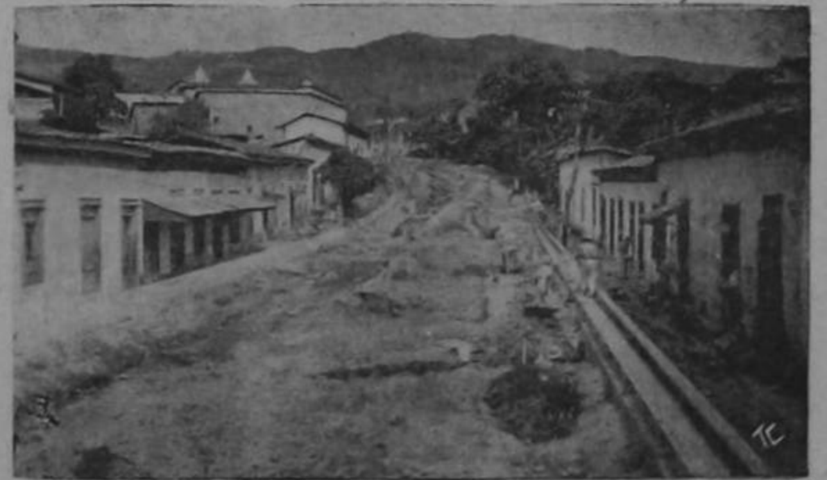
Trabajos de saneamiento y pavimentación del Barrio San Jacinto, en San Salvador, capital de El Salvador, C. A.
